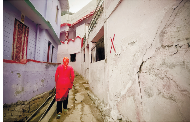
Илл. 5. Дома, находящиеся в аварийном состоянии из-за усилившегося проседания почвы, помечаются специальными опознавательными знаками. Их жители в лучшем случае могут рассчитывать на переселение, а в худшем — просто останутся на улице без крыши над головой
