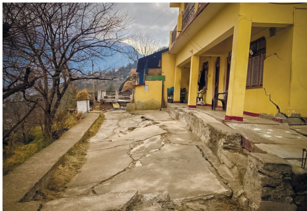
Илл. 6. Эксперты полагают, что город Джошиматх постепенно сползает с вершины холма, на котором расположен
